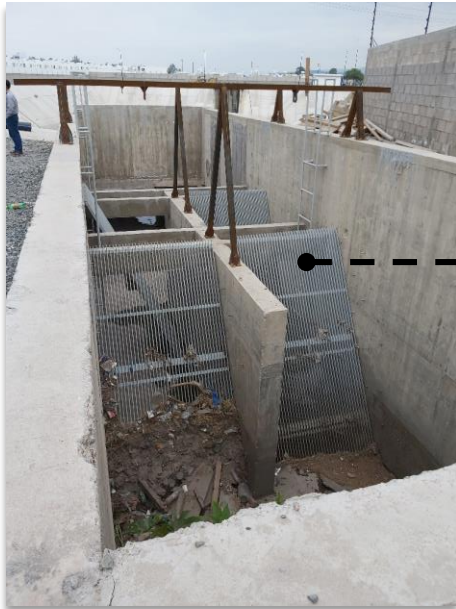
Rejillas de retención en canal de entrada
